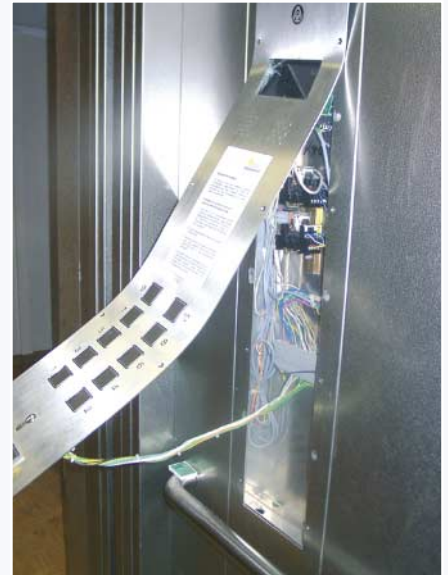
Mutwillig zerstörte Aufzugs-Steuerung
